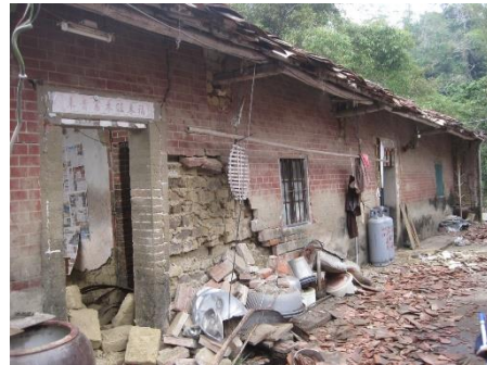
土崎 2 鄰考潭 14 號蔡福文受損情形
