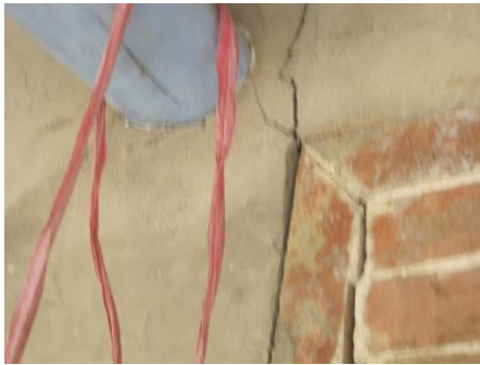
土崎 2 鄰考潭 14 號-蔡全寶(客廳龜裂)
