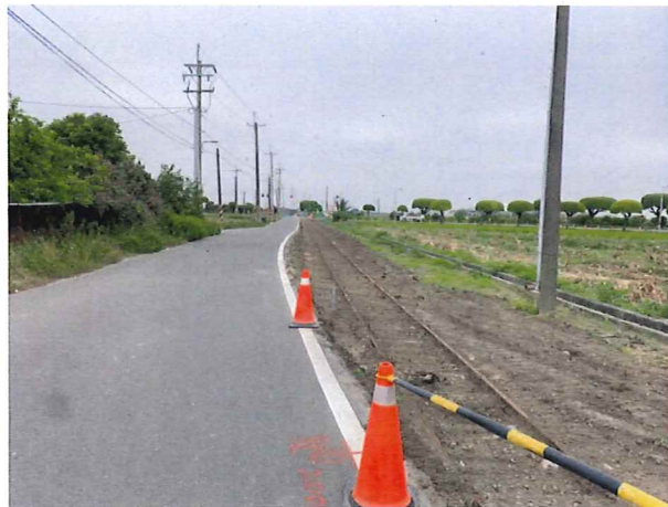
圖(3)、未設置交維設施(含警示燈)
