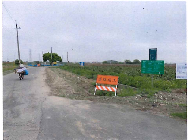
圖(2)、未設置交維設施(含警示燈)
