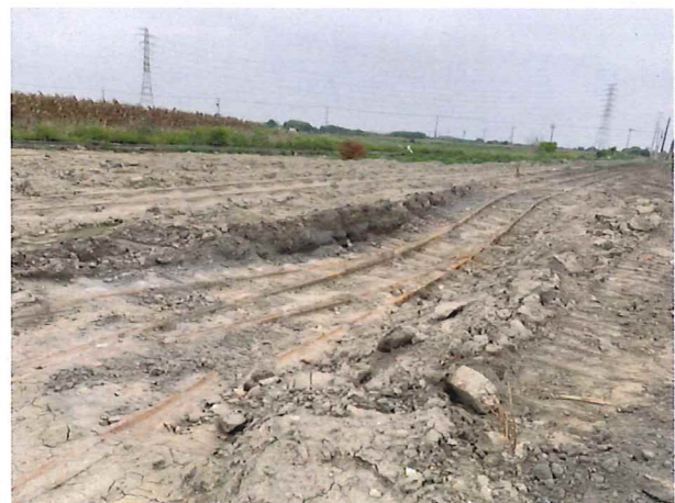
圖(6)、現地凹陷，須抬升鐵軌(辦理變更設計照片用，不用改善)
