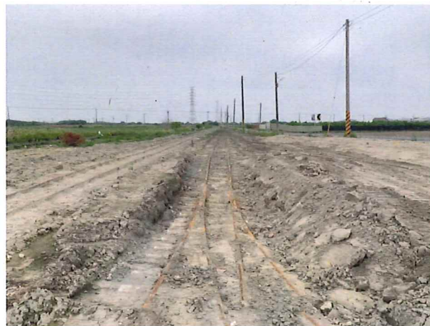
圖(5)、現地凹陷，須抬升鐵軌(辦理變更設計照片用，不用改善)
