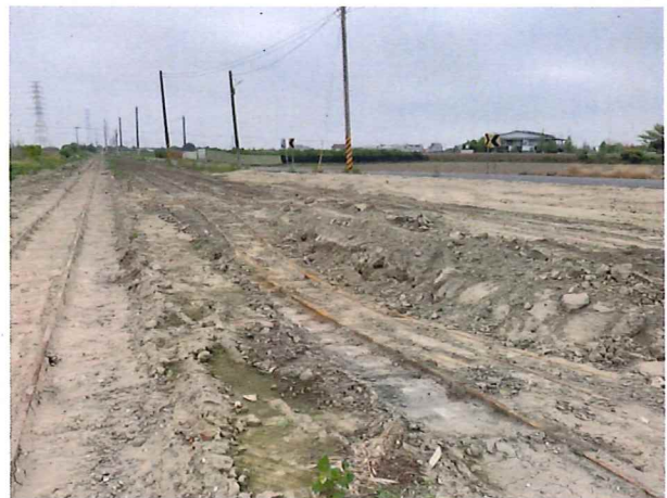
圖(4)、現地凹陷，須抬升鐵軌(辦理變更設計照片用，不用改善)
