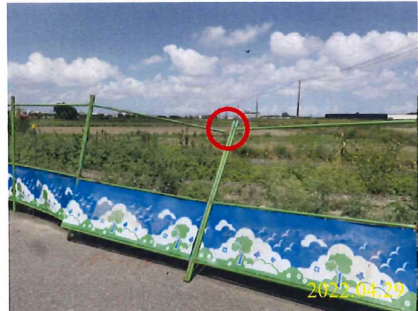
圖(4)、乙種圍籬嚴重傾斜及損壞(紅圈)
