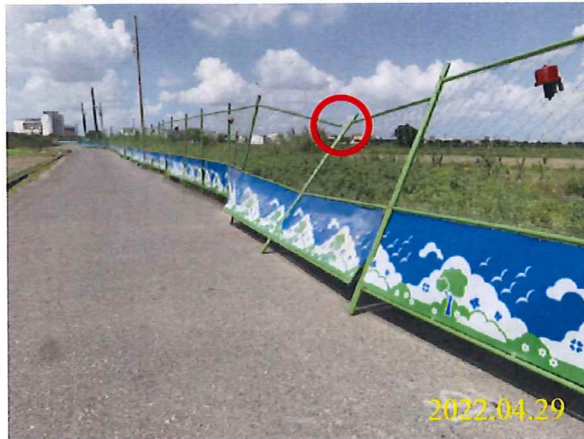
圖(3)、乙種圍籬嚴重傾斜及損壞(紅圈)
