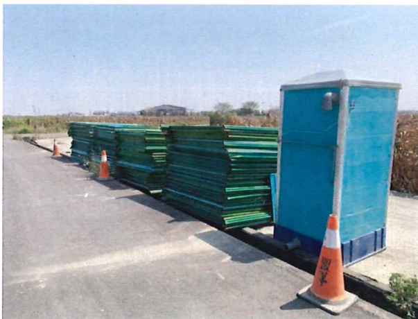
圖(5)、未設置交維設施(含警示燈)
