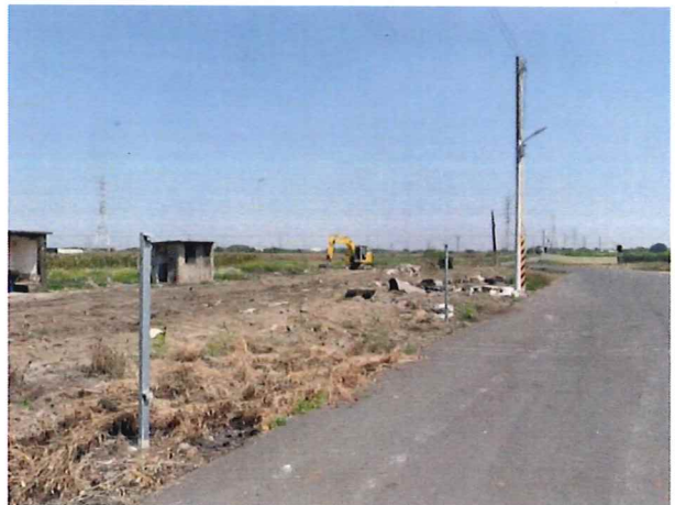
圖(4)、未設置交維設施(含警示燈)
