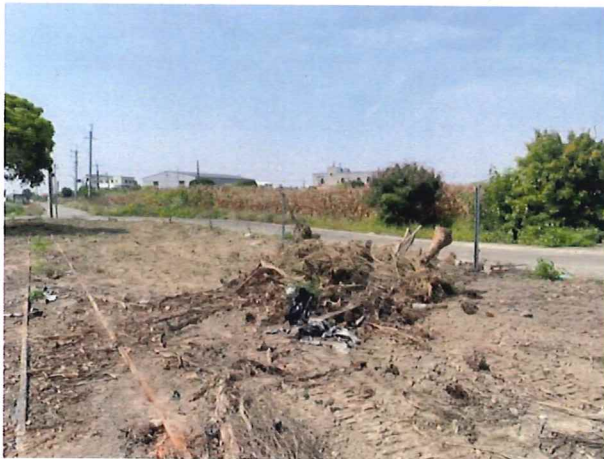
圖(9)、工地垃圾未清理
