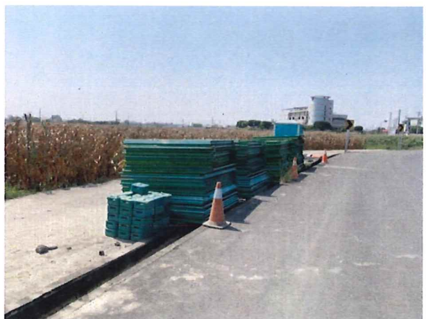
圖(6)、未設置交維設施(含警示燈)
