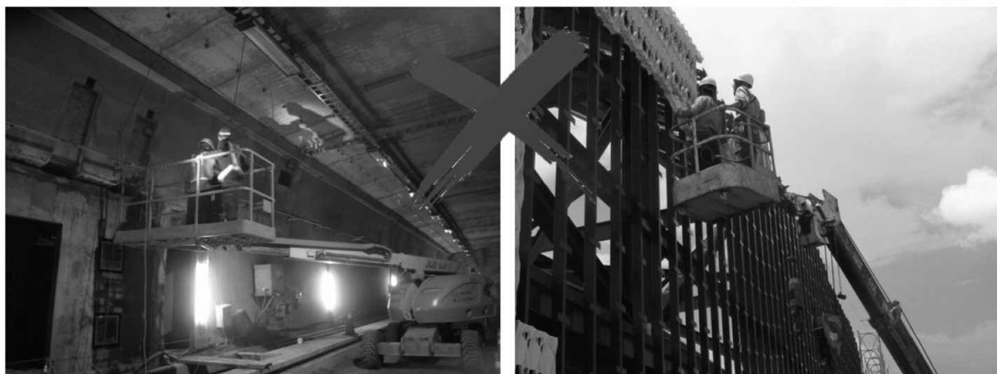
高空工作車作業勞工未使用安全帶
