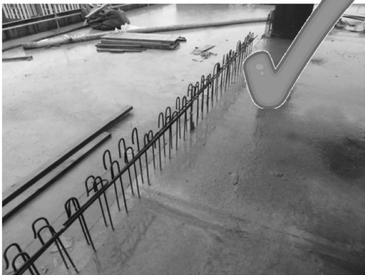
裸露鋼筋已彎曲
