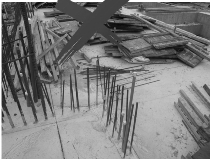
裸露鋼筋未彎曲
