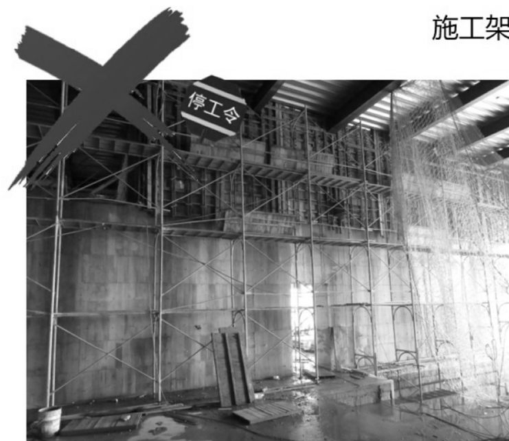
施工架無繫牆桿繫結固定於建物
