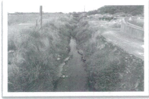
通水斷面不足
