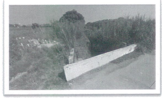
橋長及梁底高程不足
