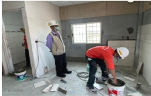
做工行善團成員在室內行「繕」工，改善弱勢族群居住環境。 (做工行善團提供)
