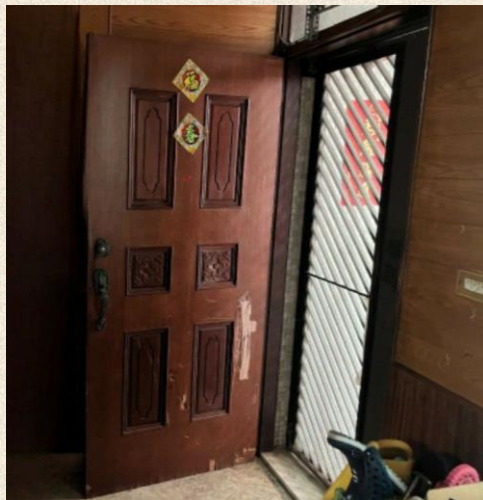
客廳門修繕前
