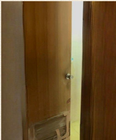
浴室門修繕前
