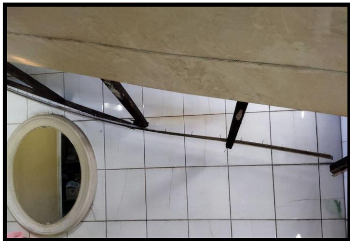
浴室天花板修繕前
