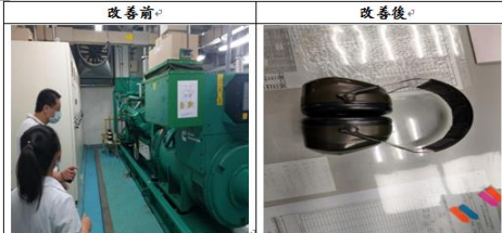
改善前 安全衛生管理 發電機室/噪音場所未設置個人防護具(耳塞、耳罩等)。
