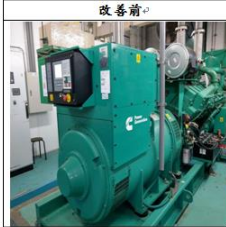
改善前 安全衛生管理 發電機室現場未存放設備檢查、測試紀錄。
