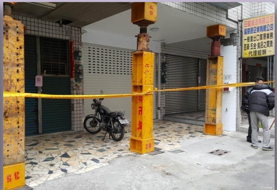
仁德區危險建築物張貼紅單
