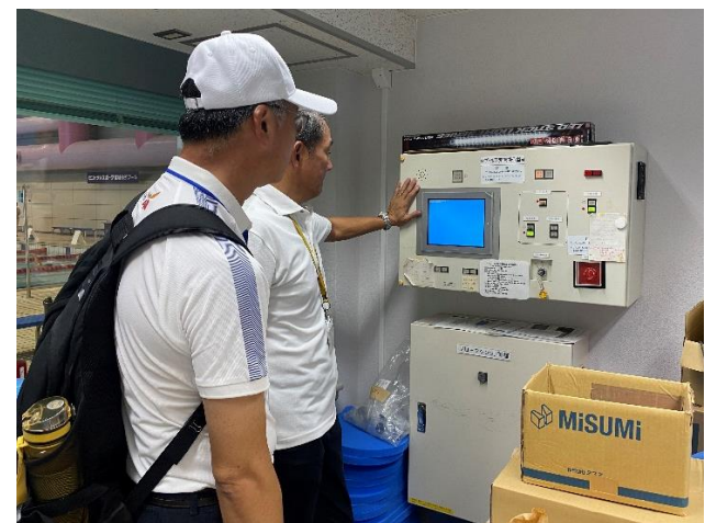
調整50m泳池地板升降之開關控制箱
