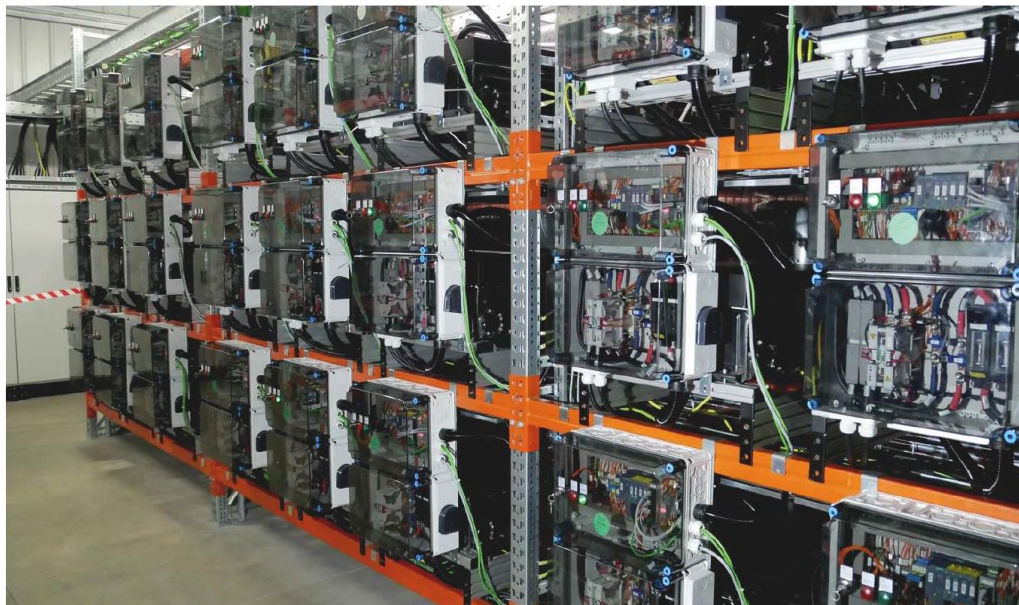
圖 20 廢舊鋰電池儲能系統
