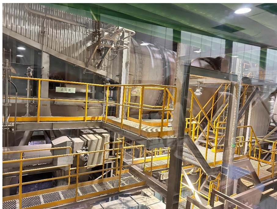
圖 56 麻浦資源回收設施焚化底渣旋轉窯燒結爐
