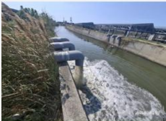
確認抽水機運作正常
