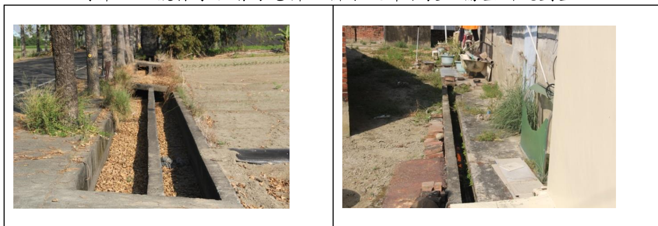
圖 37 排水不良處現況
