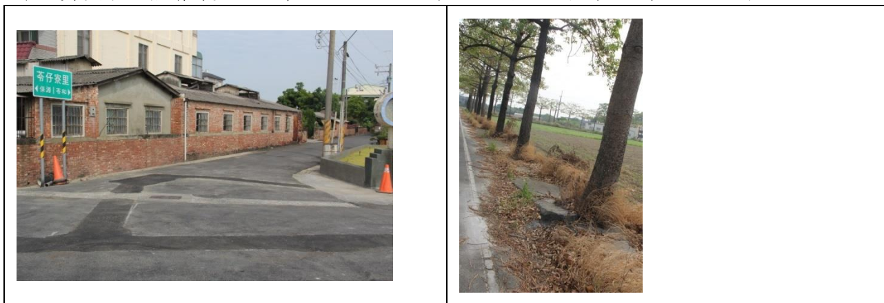
圖 38 需改善之路面現況
