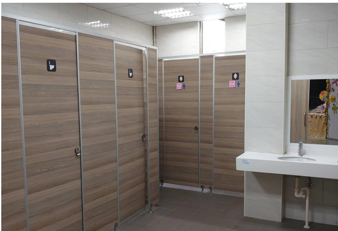
(二) 圖 4-民治市政中心南瀛堂性別友善廁所-2
