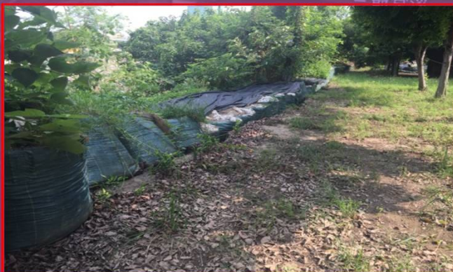
六河局新建工程(左岸)河道改向造成右岸沖刷邊坡下陷
