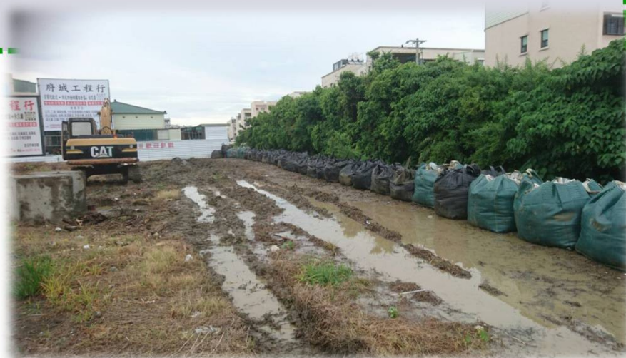
海尾寮排水上游土堤高度不足，以太空包保護
