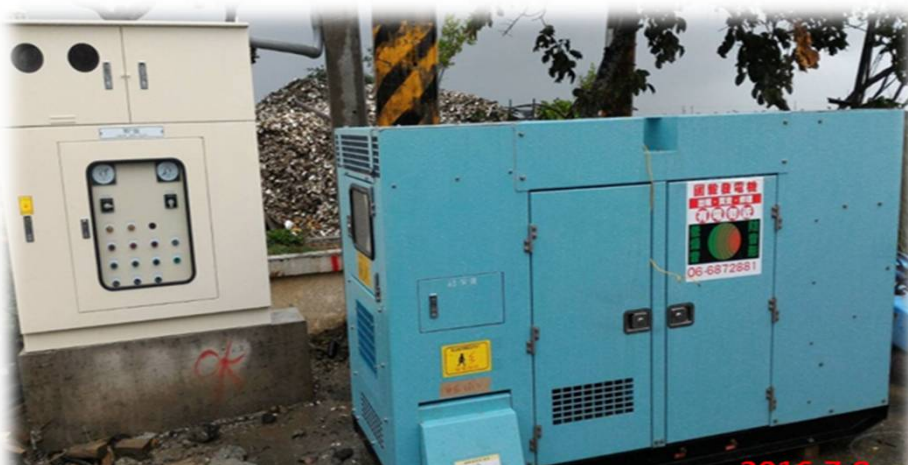
龍山社區發電機預佈情形
