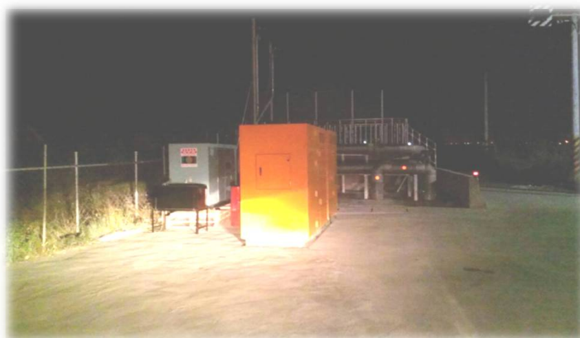
玉山社區發電機預佈情形
