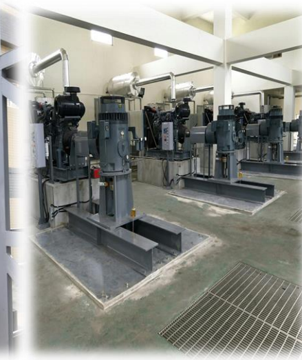
永康分洪抽水站
