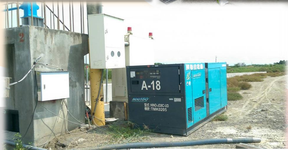
玉山、慈安社區發電機預佈完成
