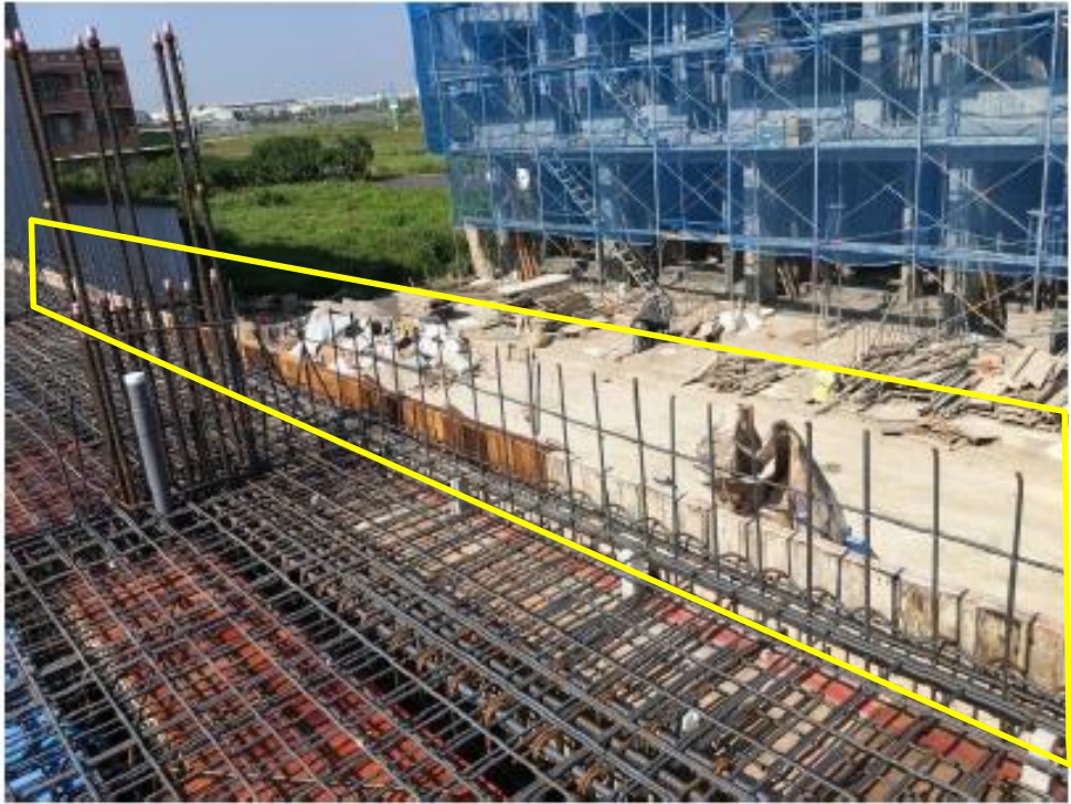
防墜護欄設置不足，已囑施工者加強。
