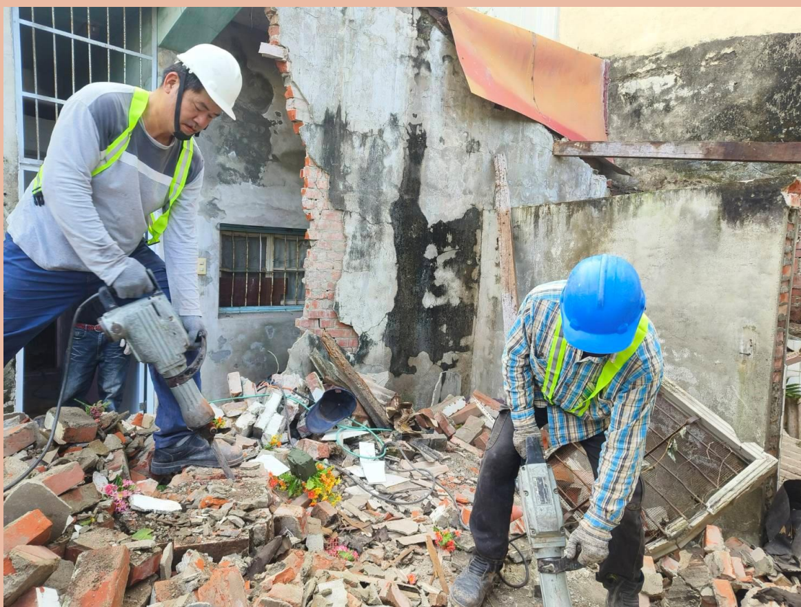
照片 1、工務局動員人力協助民眾打除受損磚牆
