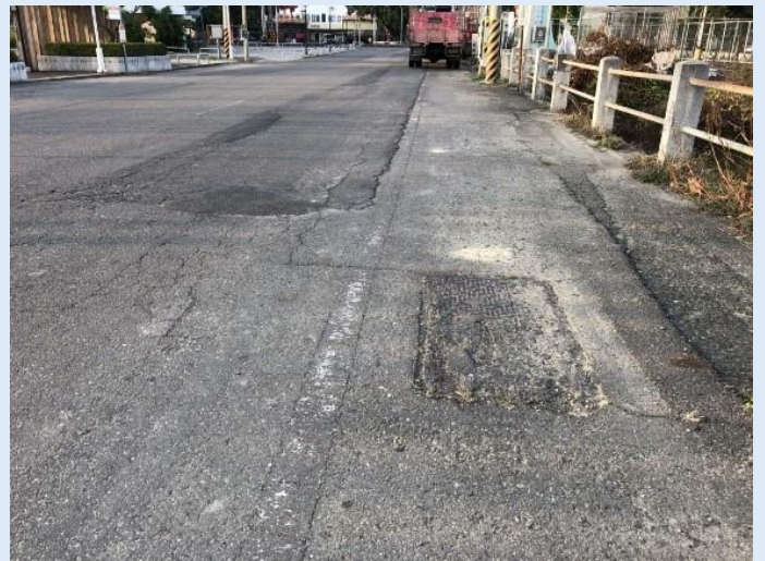
照片 2、路面因粒料膠結不良造成坑洞及修補(施工前)
