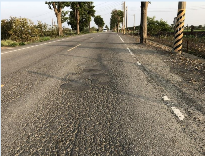
照片 1、路面年久失修產生縱橫向裂縫 (施工前)
