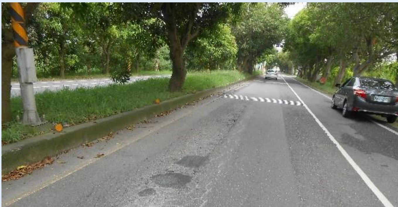
照片 2、輪跡處縱向凹陷(施工前)
