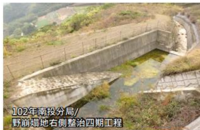
集水設施設置動物通道
