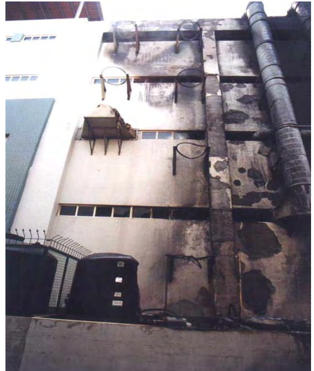
火災沿著風管路徑漫延燒毀
