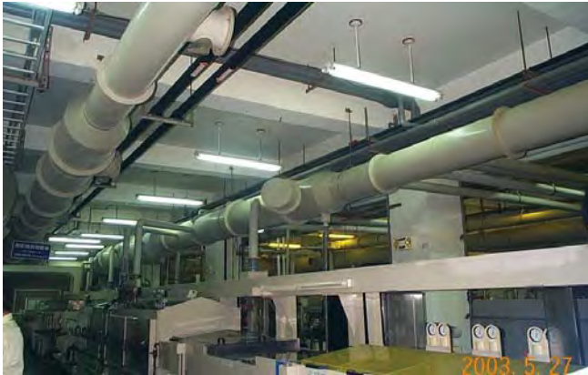
PCB廠常見塑膠機台與風管
