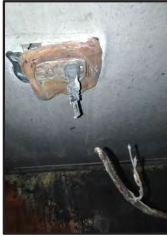
疑似工業電扇電線走火造成火災事故
