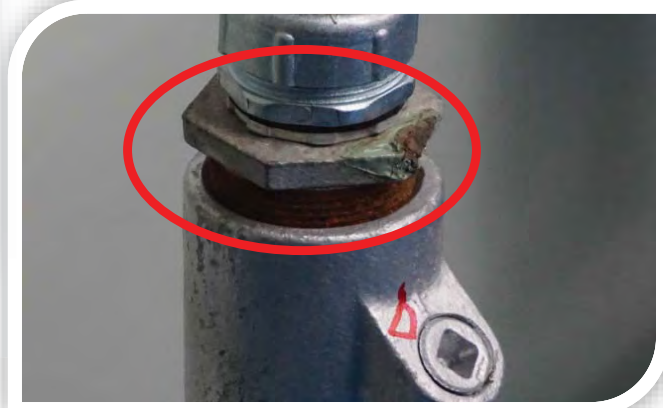
防爆管線有鏽蝕受損
