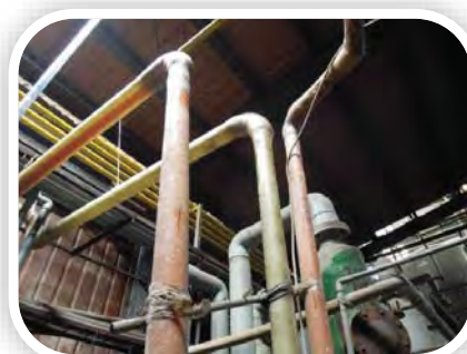
管線未明確標示
