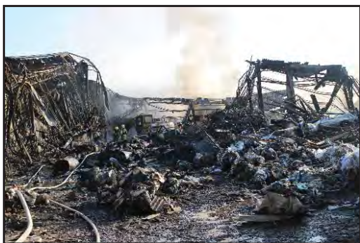
事故現場燃燒倉庫
