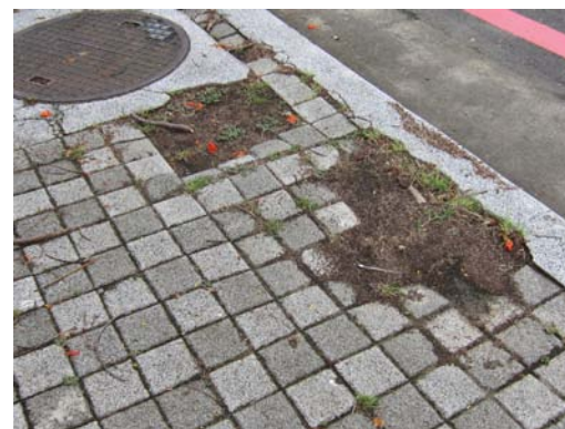
②現有舖面毀損、植穴無植栽
