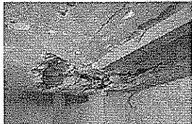
天花板鋼筋外露
