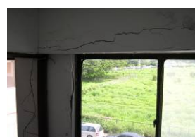
梯廳樑柱龜裂
