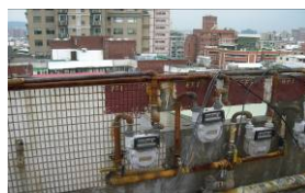
屋頂瓦斯表及管線
