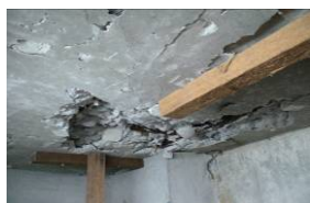
天花板鋼筋外露
