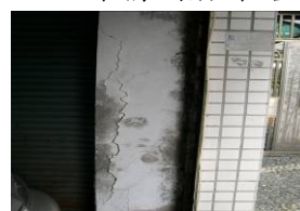
地下室柱爆裂
