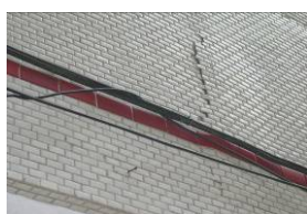
外牆立面龜裂
