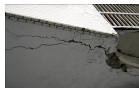
外牆鋼筋外露
