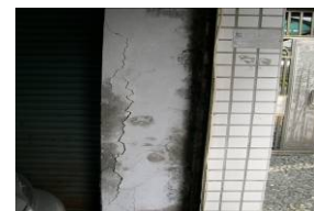
地下室柱爆裂
