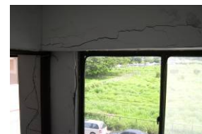
梯廳樑柱龜裂
