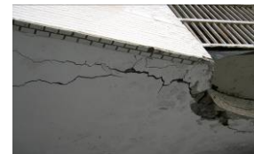
外牆鋼筋外露
