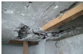
天花板鋼筋外露
