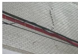
外牆立面龜裂
