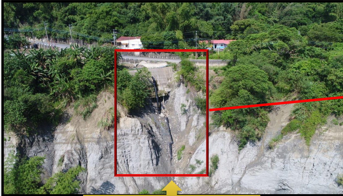
擋土牆下方掏空
