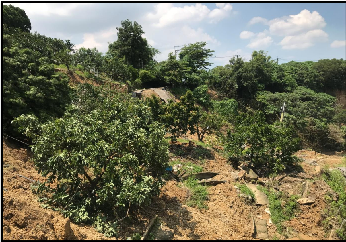
結構體破壞(邊坡、護岸)
