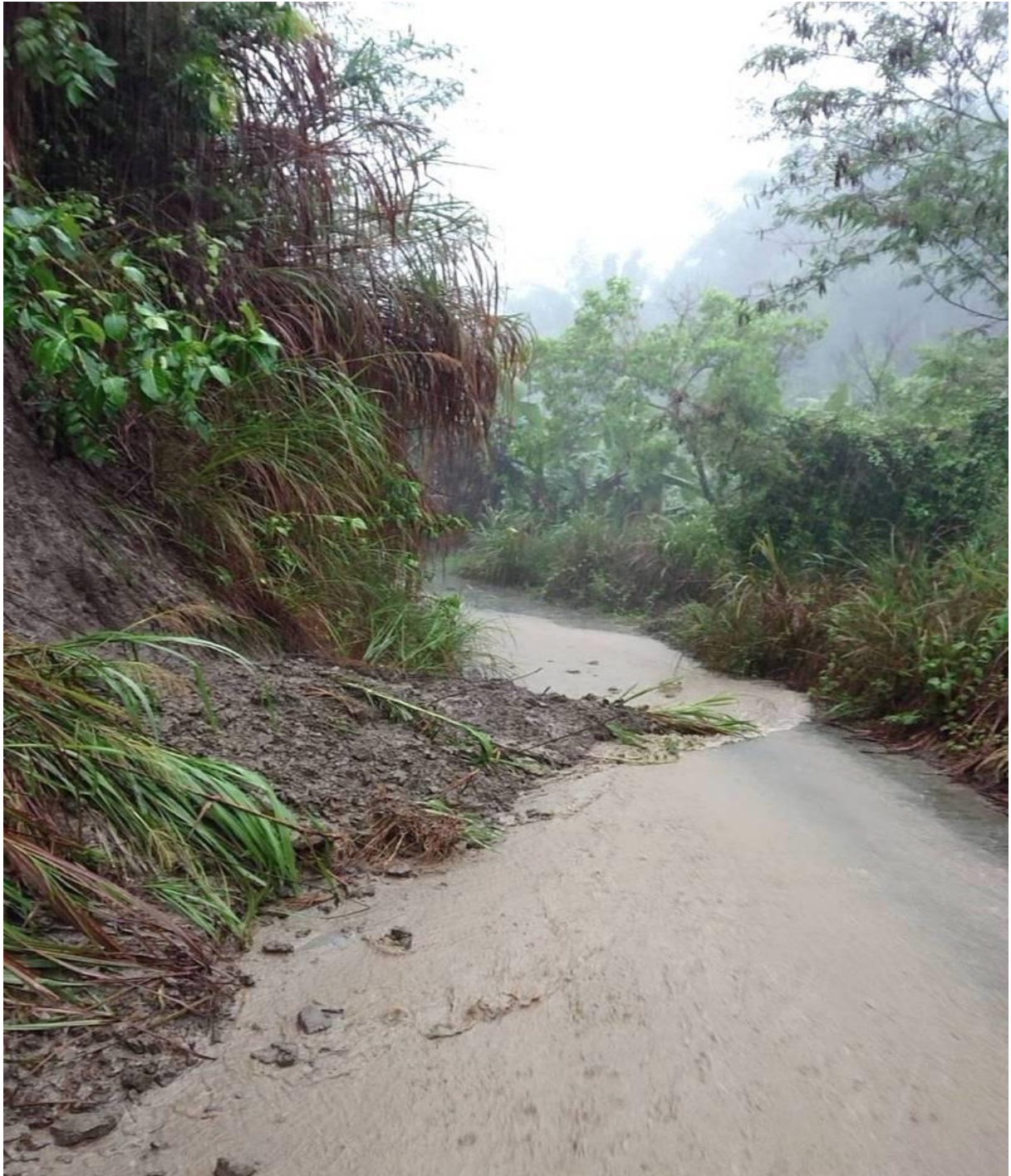
圖 29 社區產業道路邊坡崩坍照片
