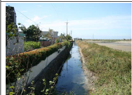
照片 32 排水設施需整治
