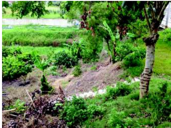
圖49. 邊坡土石滑落防護工程現況
