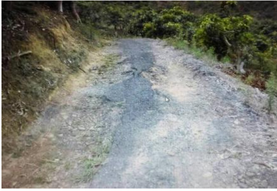
石牌緊急通道路面已損毀
