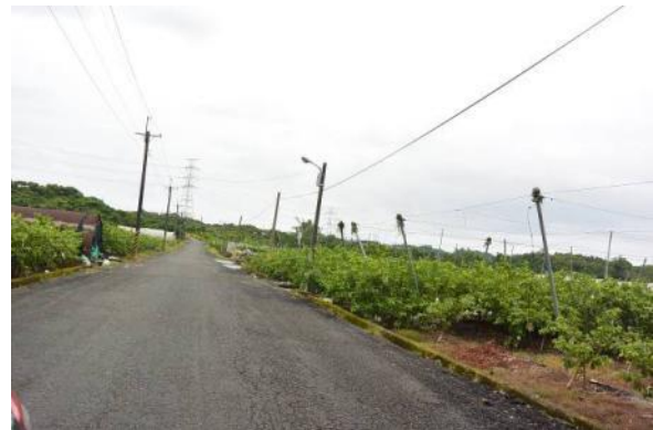
通往芒子芒大埤產業道路已多出龜裂
