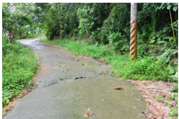
石牌緊急通道路面已損毀
