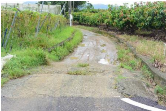
南 185 線產業道路崎嶇不平
