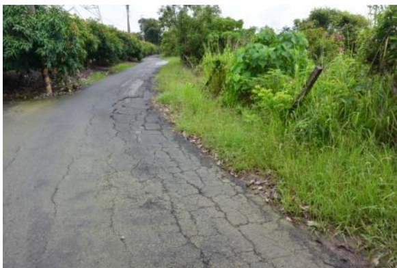
芒子芒大埤周邊道路崩塌
