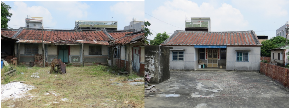
損壞老舊農舍
