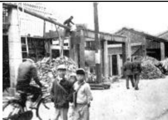
新市區新市里 139 號磚造二層旅社 倒塌。
