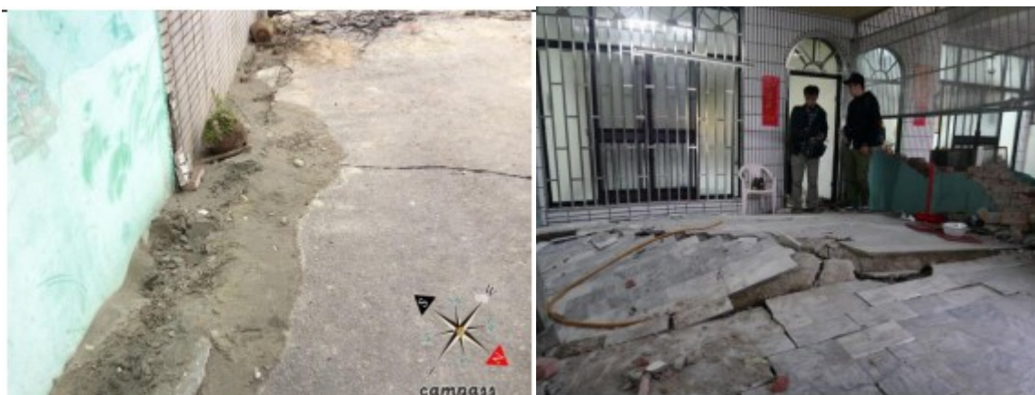
圖 2-2-8 0206 地震新市區三民街災損圖
