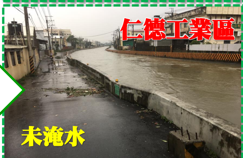
三爺溪護岸加高未溢堤
