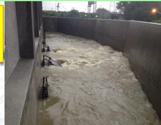
永康排水疏洪道抽水站抽水情況
