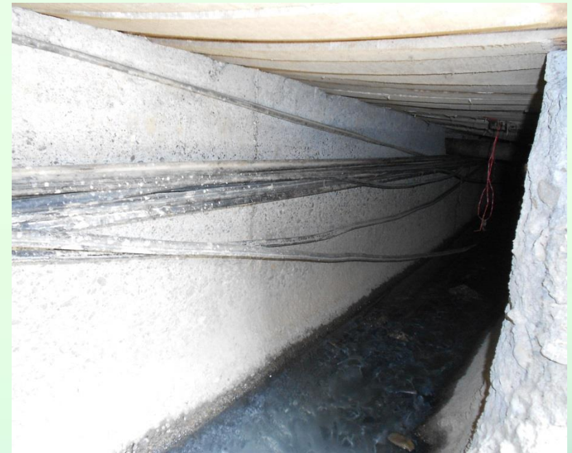
中正路道路側溝纜線掉落 容易勾到垃圾造成阻塞
