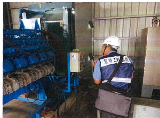
引擎帶動抽水機之柴油引擎啟動後，技師查核運轉數據。
