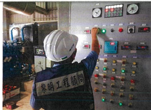
40KW 柴油發電機啟動運轉後，技師檢查柴油發電機輸出電壓。
