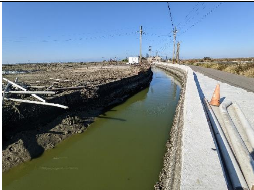
三寮灣聚落排水現況 (拍攝日期 110.12.28)
