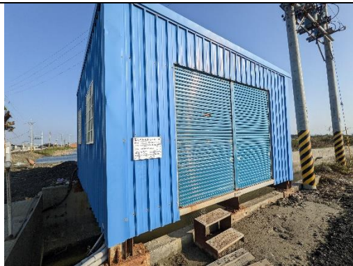
現有之抽水站 (拍攝日期 111.2.25)
