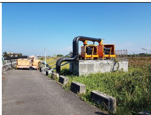
現有之機動式抽水機 (拍攝日期 111.1.25)
