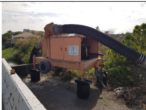
現有之機動式抽水機 (拍攝日期 111.1.25)
