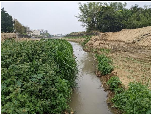
虎頭溪現受工程擾動而河道縮減 ( 拍攝日期 111 年 3 月 29 日 )
