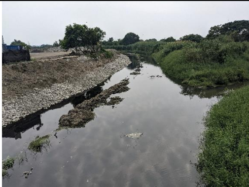
南廊排水現況 (拍攝日期 110 年 10 月 26 日)
