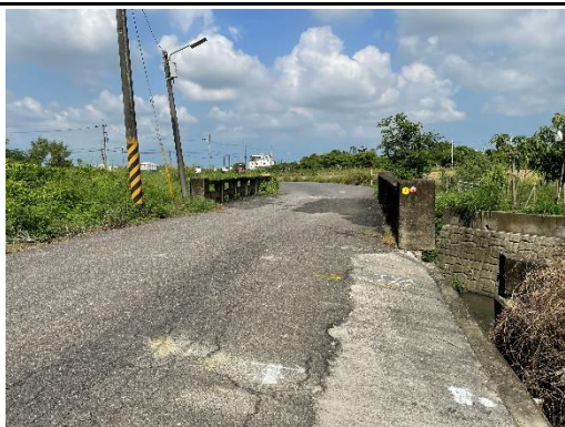
現有橋梁老舊且有裂縫 (拍攝時間 110.7.21)
