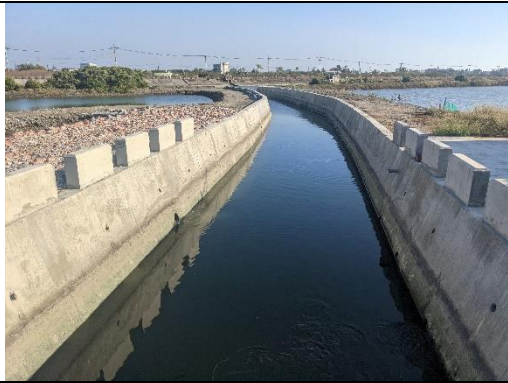
土城仔一之二排水現況 (拍攝日期 110.11.17)
