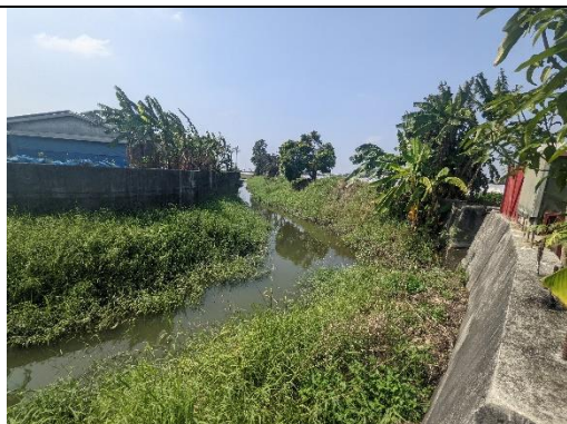
後鎮排水現況 (拍攝日期 111.2.25)
