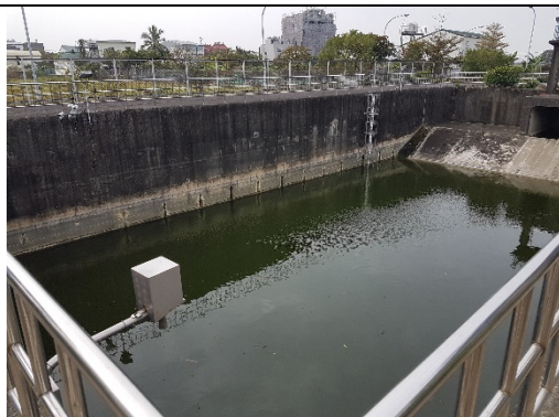
大洲抽水站內前池 (拍攝日期 111.1.25)
