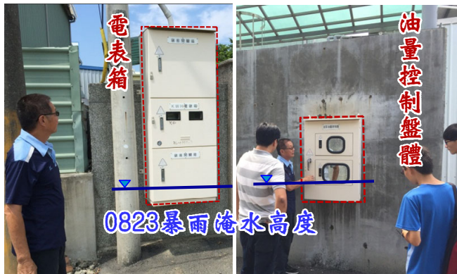
圖2-2-3 貯油槽及電表箱控制盤
