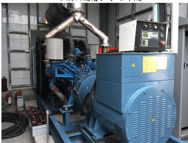
700KW 柴油引擎發電機
