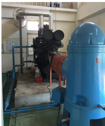
圖2-2-3 5號豎軸式抽水機組
