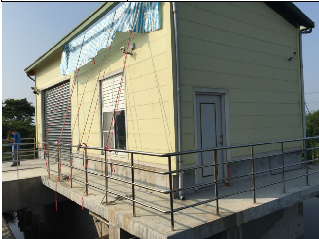
下溪洲應急抽水站外觀
