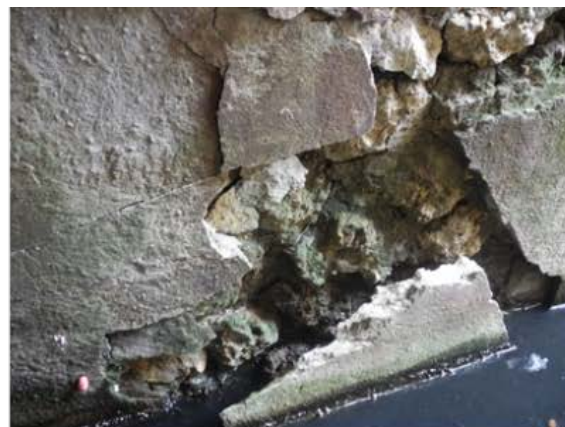
圖 A：全臺首學大樓後方水泥溝體壁面剝落，裸露下方硃砧石
