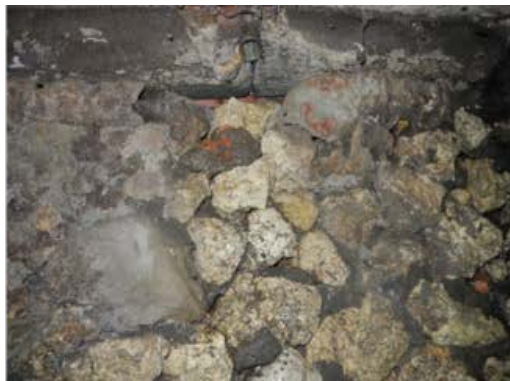
圖 E：水泥重新修補過之硃砧石
