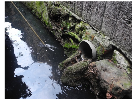
D. 局部生活汙水排入河道
