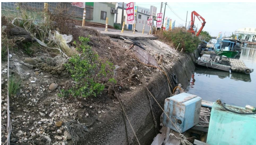
碼頭堤岸年久破損失修
