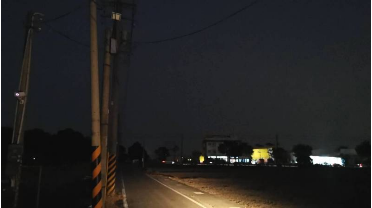
歸仁區連2夜突然有路燈不亮，公所緊急查報，協助台電排除故障。(記者吳俊鋒翻攝)
